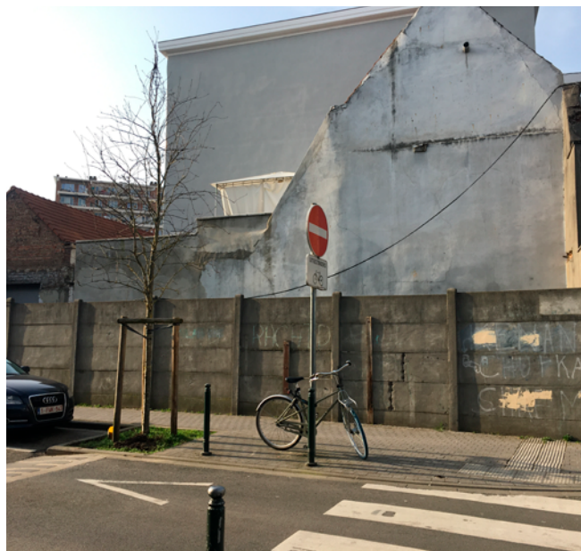
FIG. 7 Opeenvolging van woningen in slechte staat binnen de perimeter van het DWC Credits: © CityTools, april 2021
